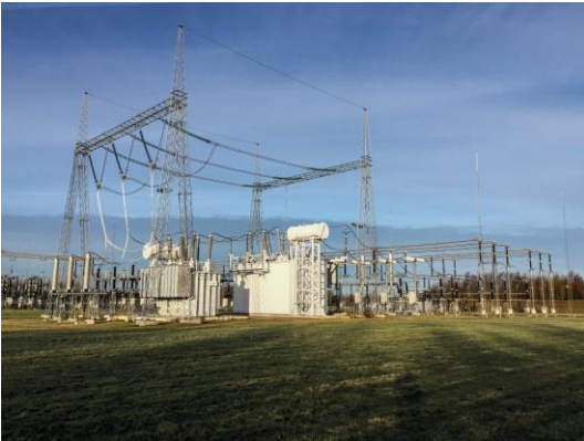
Figur 5: Billede af transformerstationen i Bjæverskov fra Energinet
