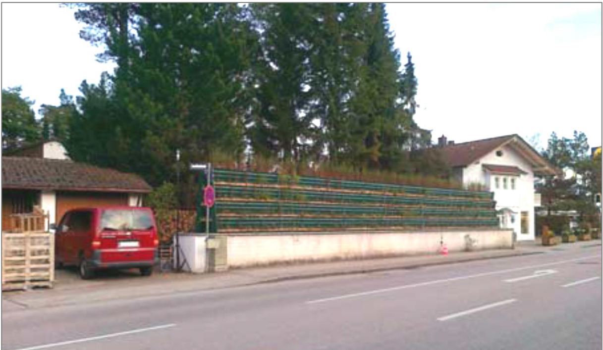
Figur 14 Støjskærm med beplantning etableret i stedet for hæk på 1,2 m høj muret væg. Kilde: [15].
