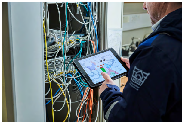
Skolfastigheter i Stockholm styrer ved hjælp af Stokabs fibernetværk skolernes varme og ventilation fra et centralt kontrolrum. Foto: Peter Philips
