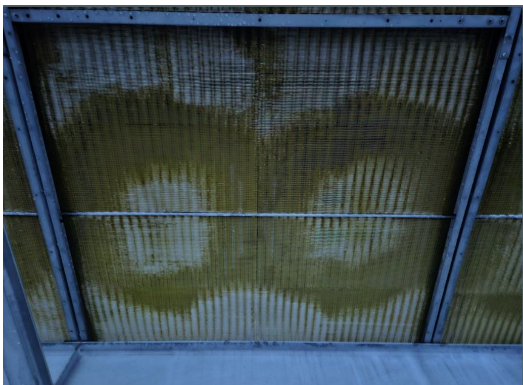
Figur 10: Undersiden af en fordamper med nedadgående luftstrøm, som viser isdannelse langs kanterne og under ventilatoren. Dette er et tegn på en dårlig luftfordeling.
